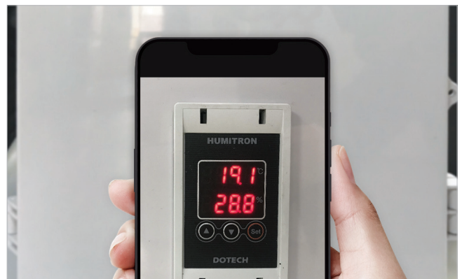
2 온습도 설비 게이지 사진 촬영
